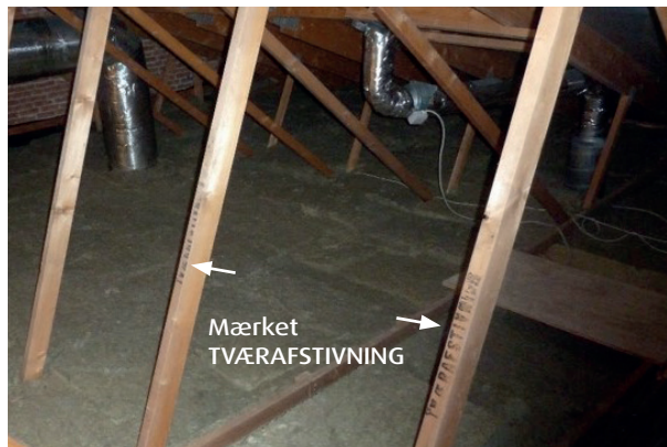
Figur 10 Gitterstænger, som er mærket TVÆRAFSTIVNING, der dog ikke er udført. Foto: Arne Elkær A/S.
