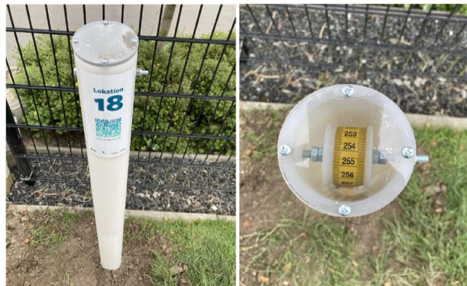
Figur 2.1: Eksempel på citizen science målestation, som er udviklet af NIRAS i VUDP projekt GRAVA, se /3/. Pejlerøret er påmonteret plexiglas, hvor borgeren nemt kan aflæse vandstanden på et målebånd. Målingen indrapporteres automatisk til en database ved at borgeren indscanner en QR-kode og registrerer den aflæste vandstand, se www.vandkortet.dk .
