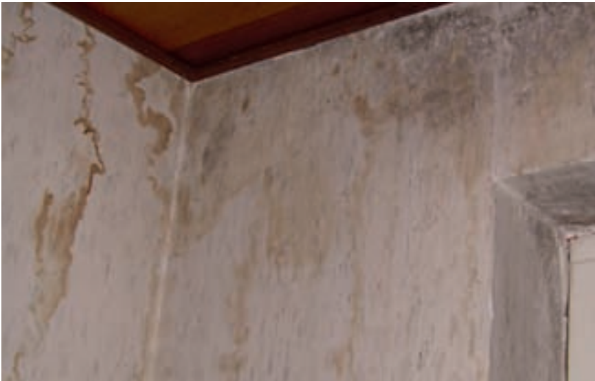
Omfattende fugtskader og skimmelsvampevækst
