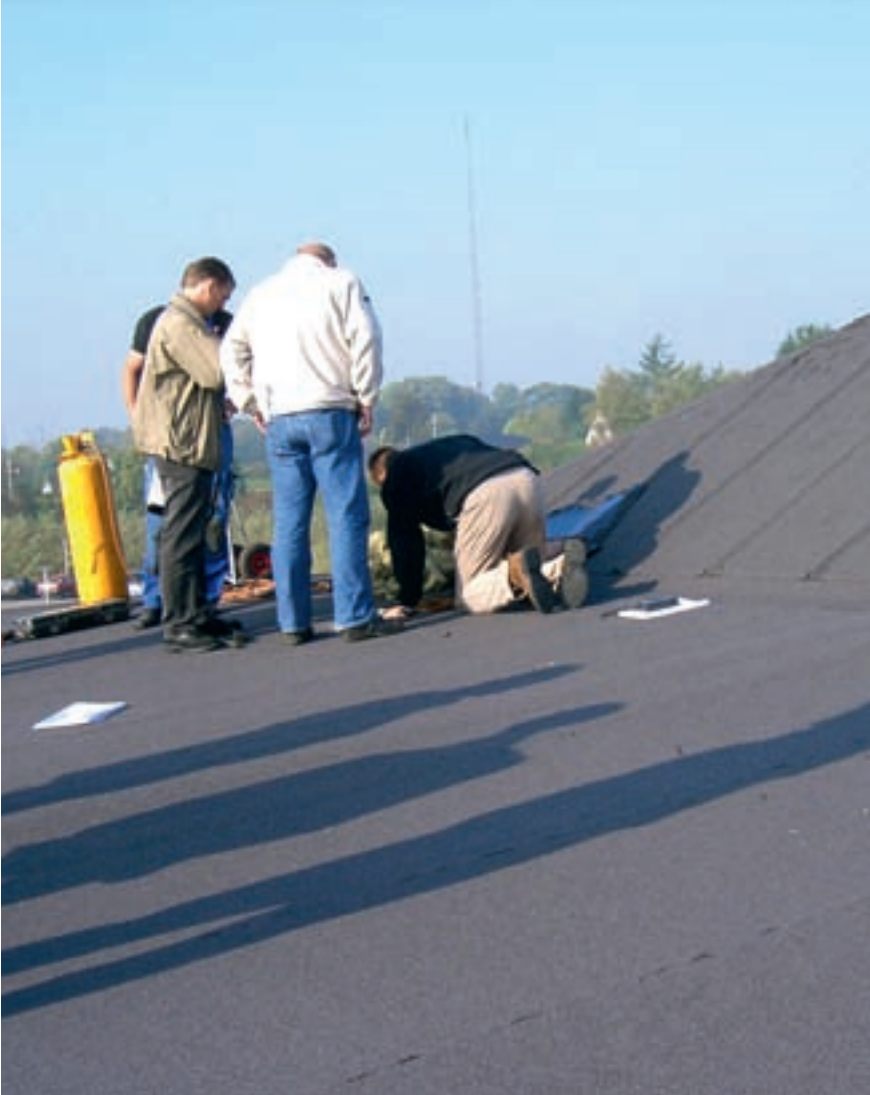
Forskellige aktører i færd med at undersøge skimmelsvampeskade.
