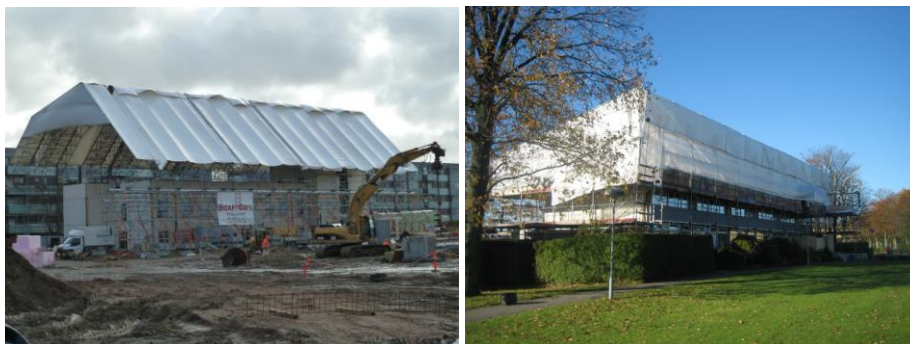
Figur 4. Eksempler på totaloverdækning. I stedet for partiel overdækning, der kun dækker materialerne, arbejdes der under en teltlignende overdækning, så der kan arbejdes uafhængigt af nedbørssituationen.
