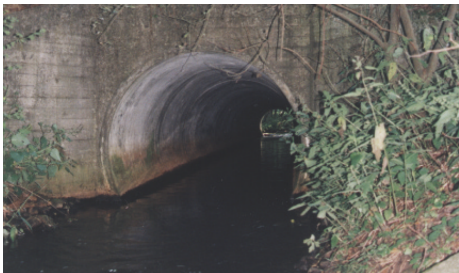
Vådpassage i form af et rør
