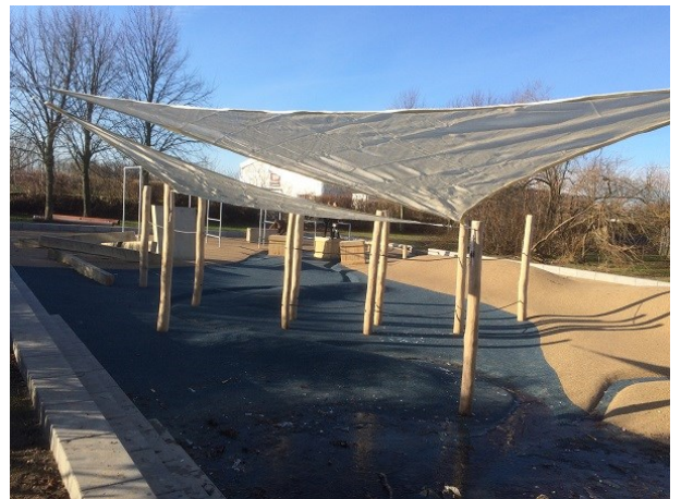
BILLEDE 20 FÆRDIGT ANLÆG.
