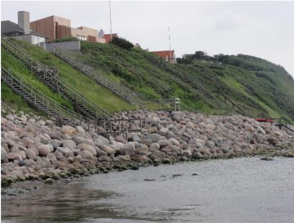
FIGUR 10 EROSIONEN FORTSÆTTER FORAN SKRÅNINGSBESKYTTELSE, OG STRANDEN FORSVINDER MED TIDEN.
