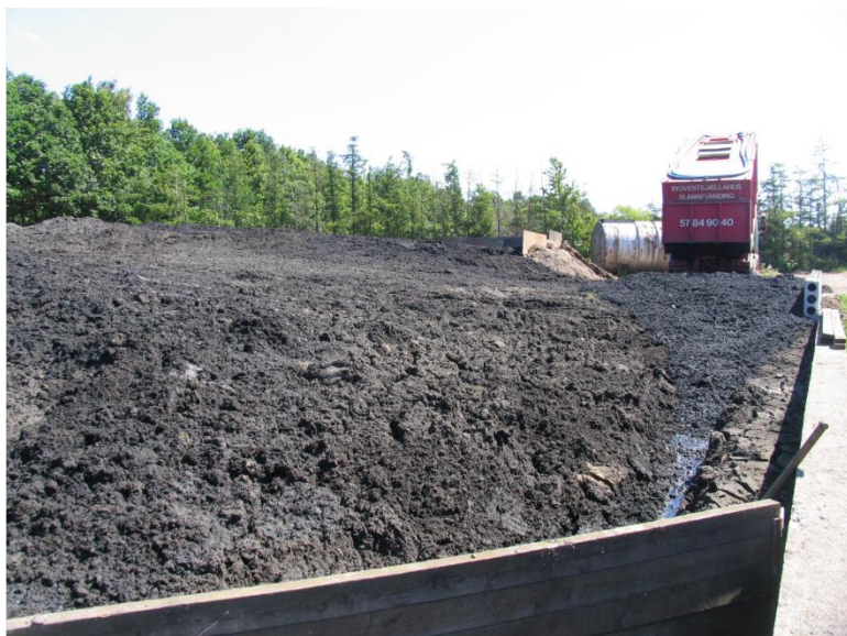
Figur 6-17: Sediment på afvandingsplads
